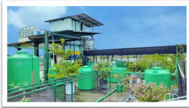
b. IPAL RSU PKU Muhammadiyah Bantul Gedung Selatan (Baru)
