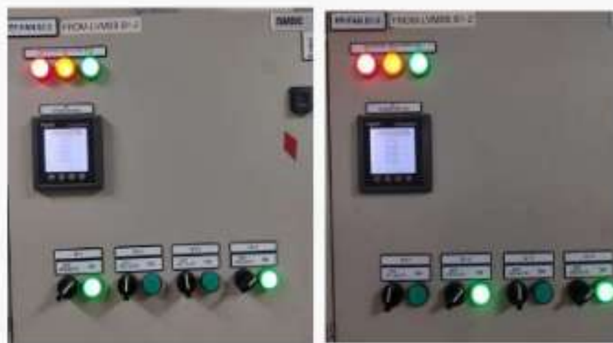
Gambar 8. Tampilan utilisasi jet fan pada panel PP-Fan B3.2 (kiri) dan B3.3 (kanan) yang terdapat pada area parkir basement level 3
