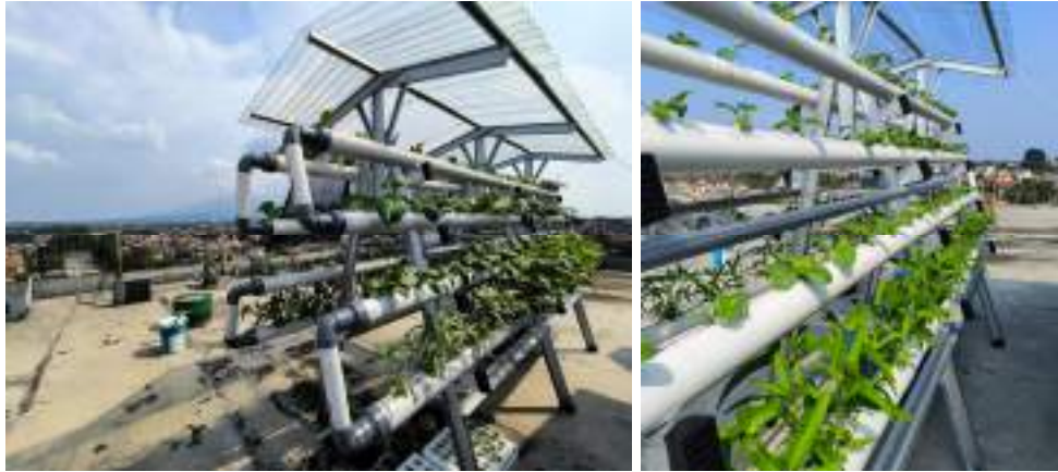
Gambar 4. Rooftop sesudah instalasi hidroponik
