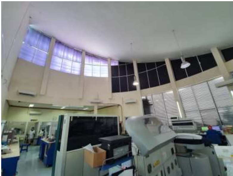
Gambar 1a. Kondisi plafon ruang laboratorium sebelum perbaikan
