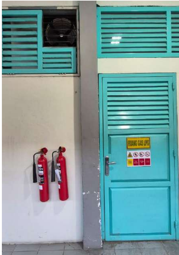
Gambar 5. Ruangan penyimpanan gas LPG
